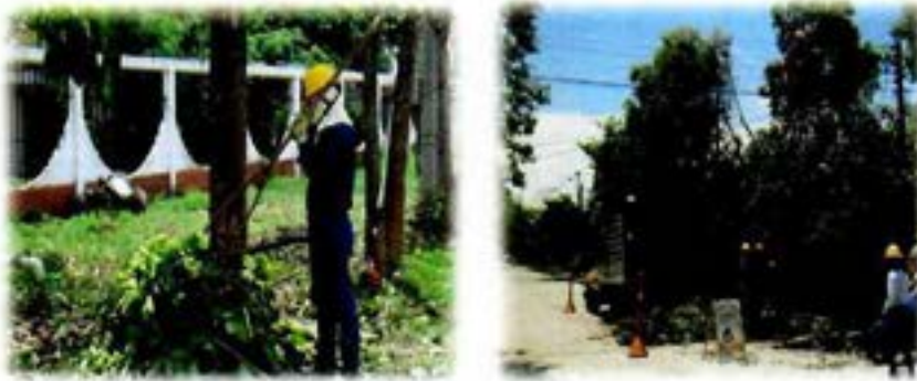
Ilustración 7. Mantenimiento de servidumbre redes urbano y rural
