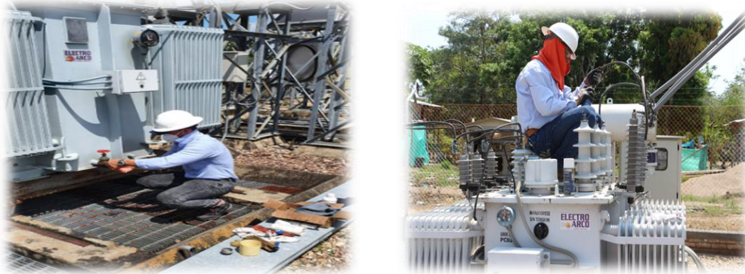
Ilustración 13. Mantenimiento de subestaciones
